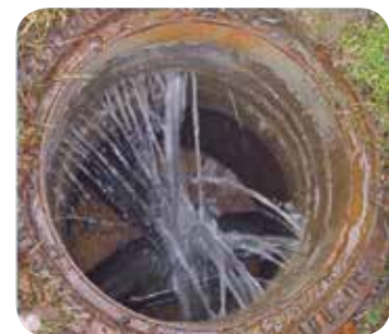
Grundwassereintritt im undichten Kanalschacht.
