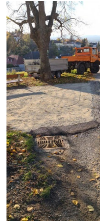
Bei der Lindenallee auf Höhe des Friedhofs wurde von den Mitarbeitern des Bauhofs eine adäquate Entwässerung verlegt.
