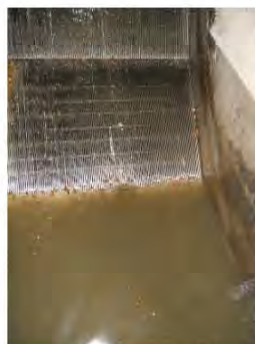
Foto: Abwasser im Zulauf der Kläranlage
