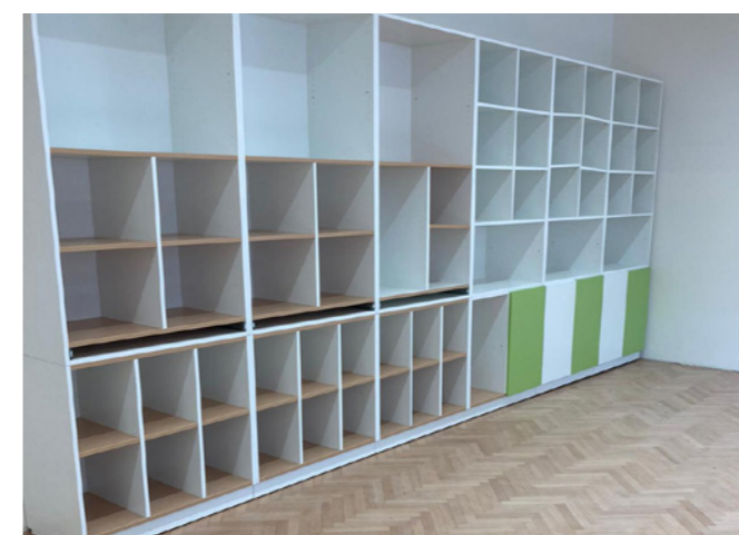
Die Sanierung der Bestandsklassen ist beinahe abgeschlossen. Die Böden wurden geschliffen, die Wände ausgemalt und die Leuchten erneuert. Moderne Ausstattung ermöglicht in Zukunft ein digitales Lernen.
